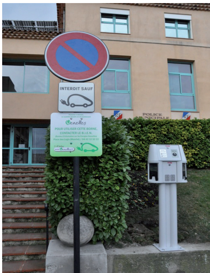
Punto de carga para los coches eléctricos instalado delante del Ayuntamiento de Venelles A terminal for electric cars installed in front of Venelles City Hall
